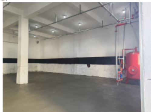
消防喷淋设备
