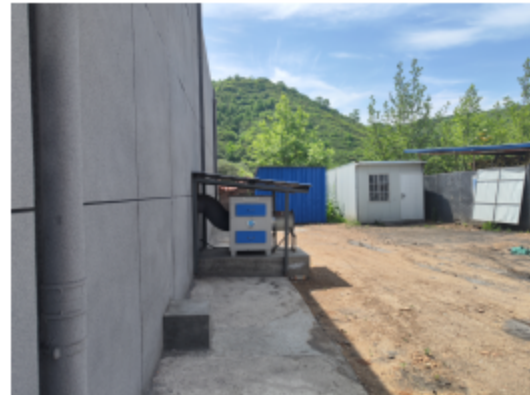
活性炭吸附箱（废油桶暂存间）
