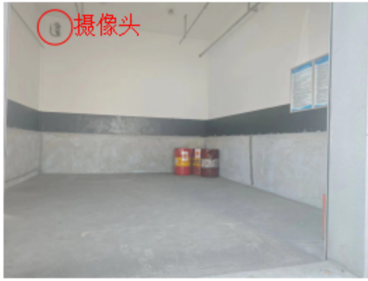
废矿物油暂存间
