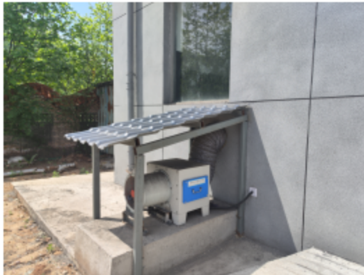
活性炭吸附箱（COD及氨氮分析残液暂存间）
