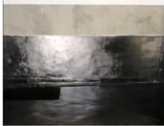
废矿物油暂存间（施工期）
