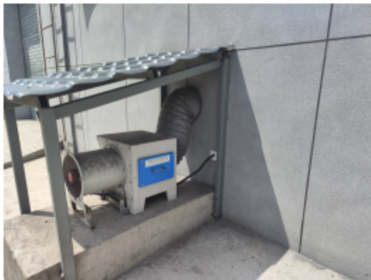
活性炭吸附箱（废矿物油暂存间）
