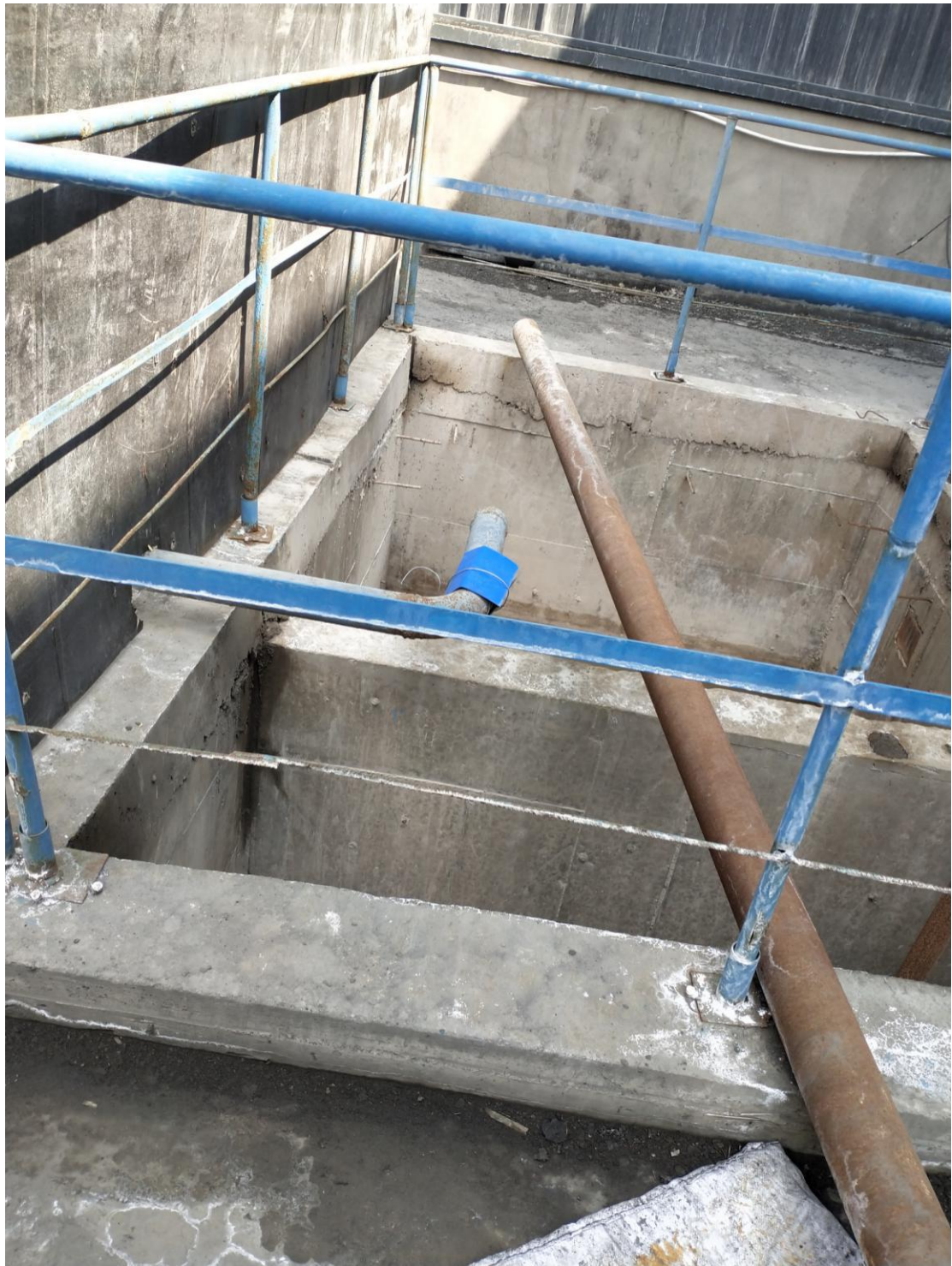
蒸汽冷却水收集池
