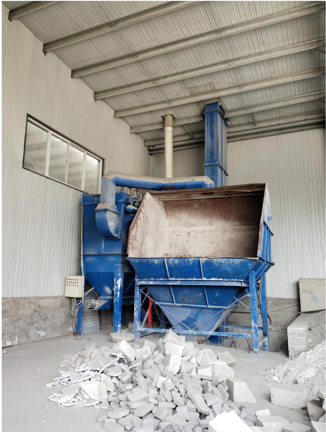
颚式破碎机及布袋除尘、提升机
