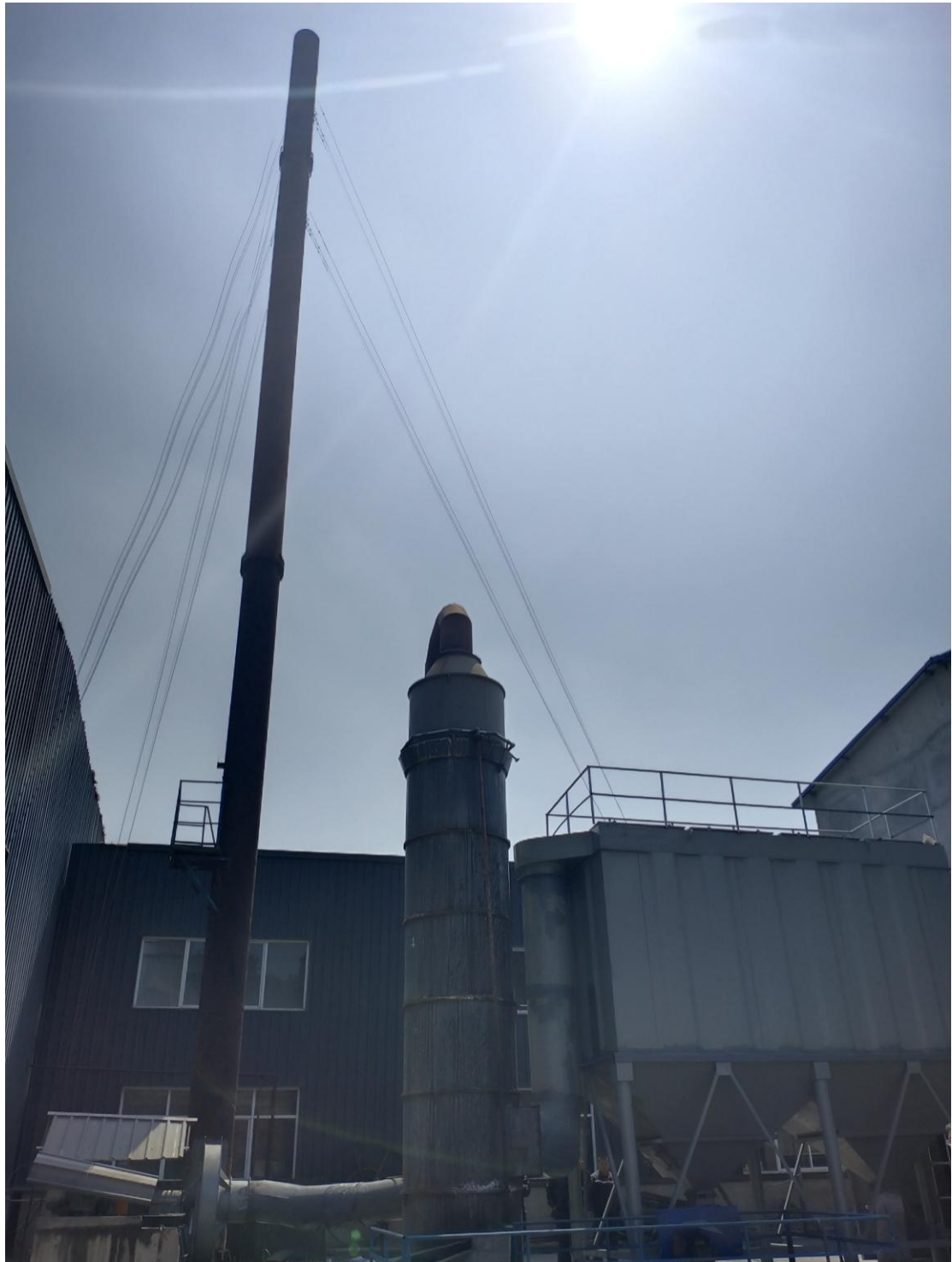
锅炉废气处理设施及排气筒
