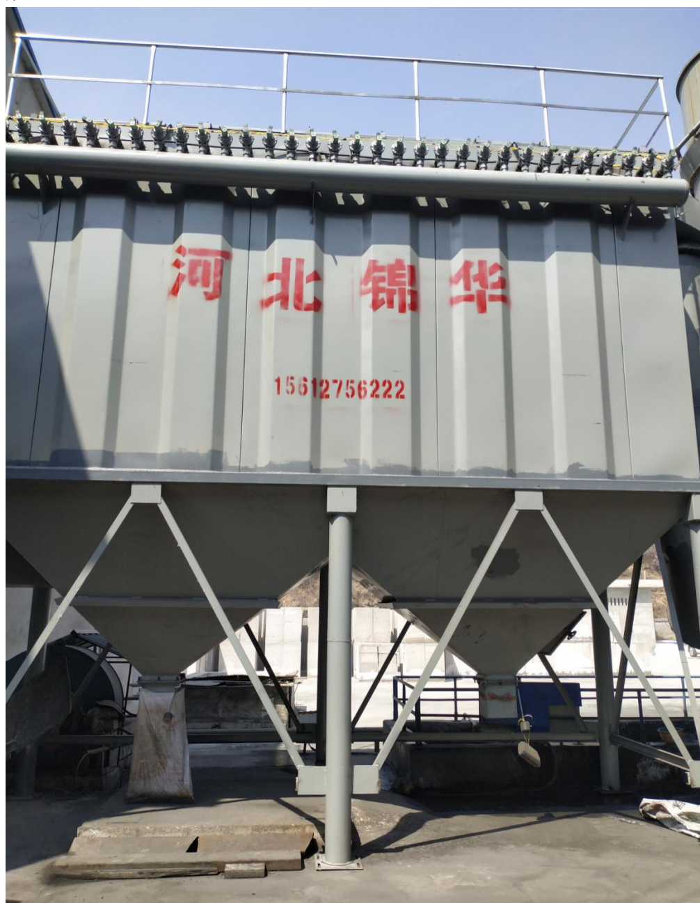
锅炉废气布袋除尘器
