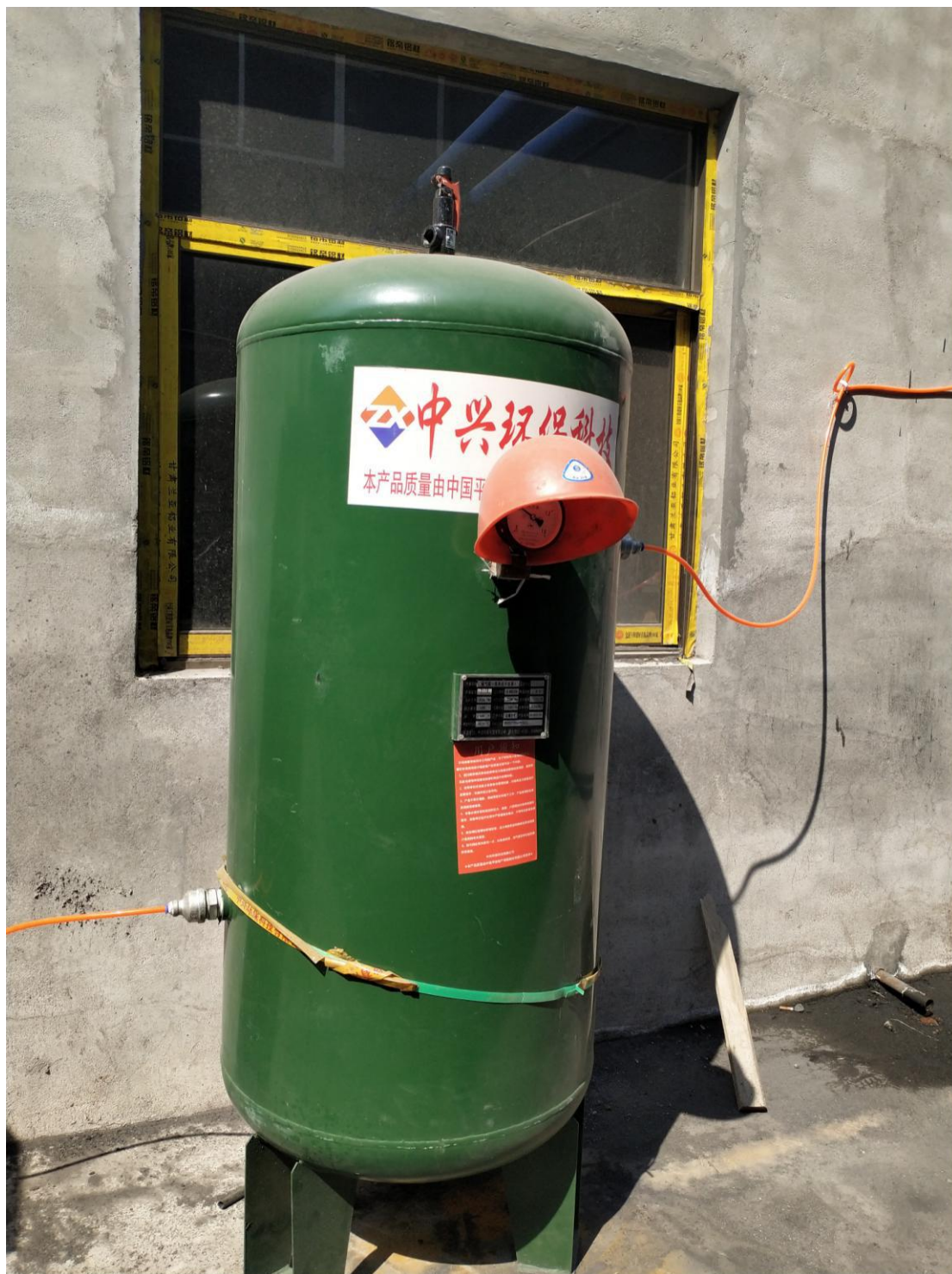
布袋除尘器压力冲洗设备
