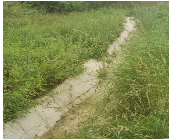
灰渣场周围的截洪沟
