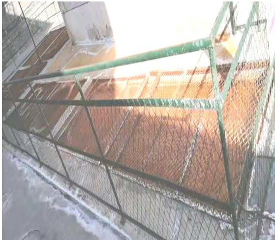
热水锅炉循环水池
