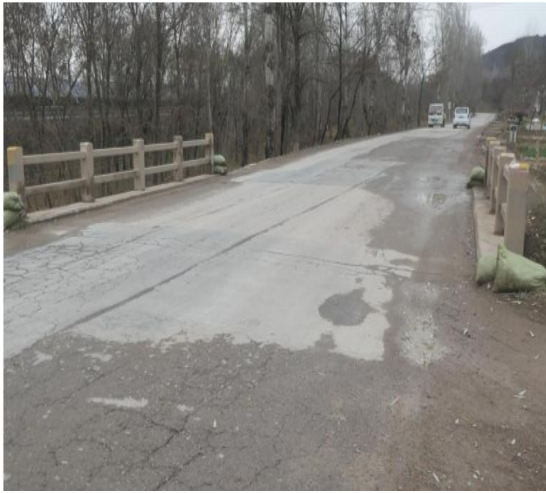
原有桥面破损现状
