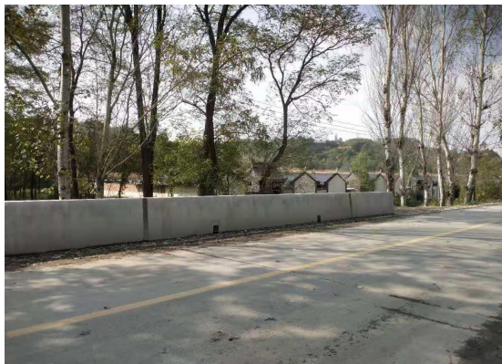
桥面径流收集口
