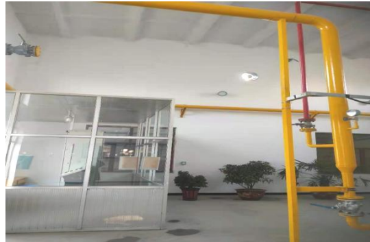
锅炉房隔声操作间及换气扇
