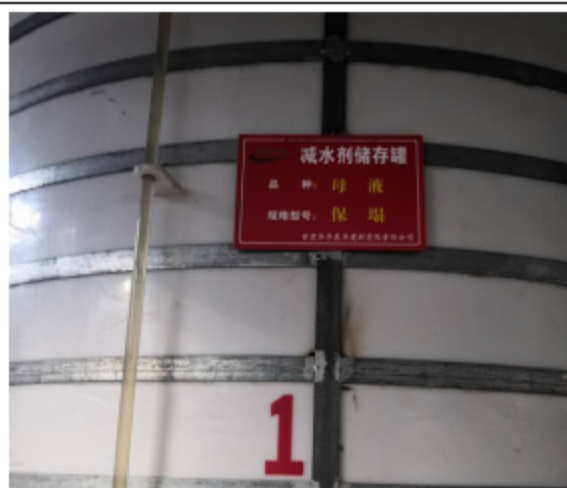
减水剂储存罐
