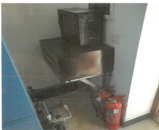
稳压电源及灭火器
