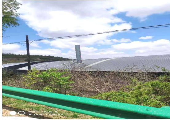
排气筒（厂房外）
