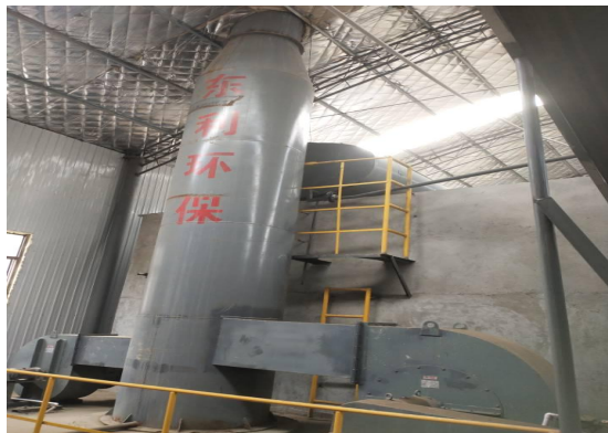
排气筒（厂房内）
