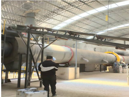
烘干滚筒、降尘室（位于烘干滚筒后侧）
